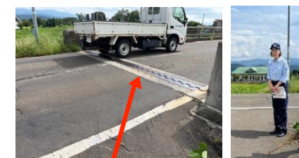
昨年も段差解消をした橋梁ジョイント部分。 スリップ事故などの危険も。（三和区内）
