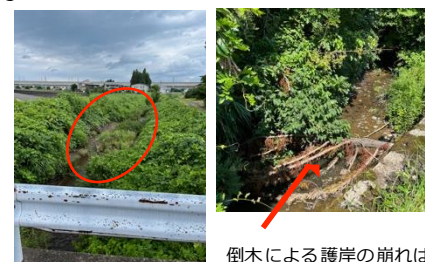
倒木による護岸の崩れは被害を増大させる要因に。 支流の倒木対応も要望。（三和区内） 猛暑と雨で護岸の雑草は伸び放題。流れに関わる場所は度々要望。（旧市内）
